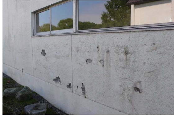
校舎外壁の劣化状況
