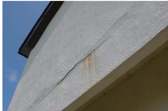
体育館妻壁のクラック
